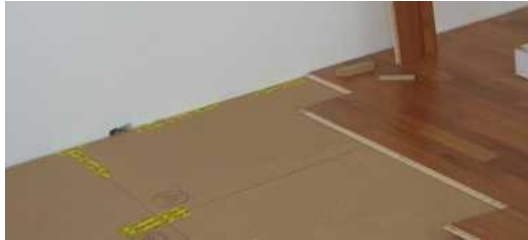
Bild: Abschirmung gegen Erdstrahlung unter einem schwimmend verlegten Fertigparkett in einer Naturheilpraxis.
