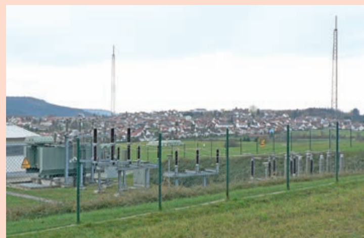
Das Umspannwerk Gosheim im Industriegebiet Sturmbühl
