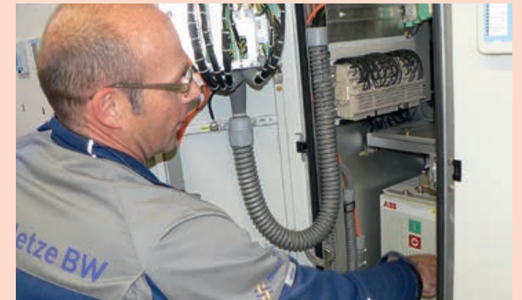
Wilhelm Burkard von der Netze BW kontrolliert einen Leistungsschalter im Umspannwerk Gosheim.
